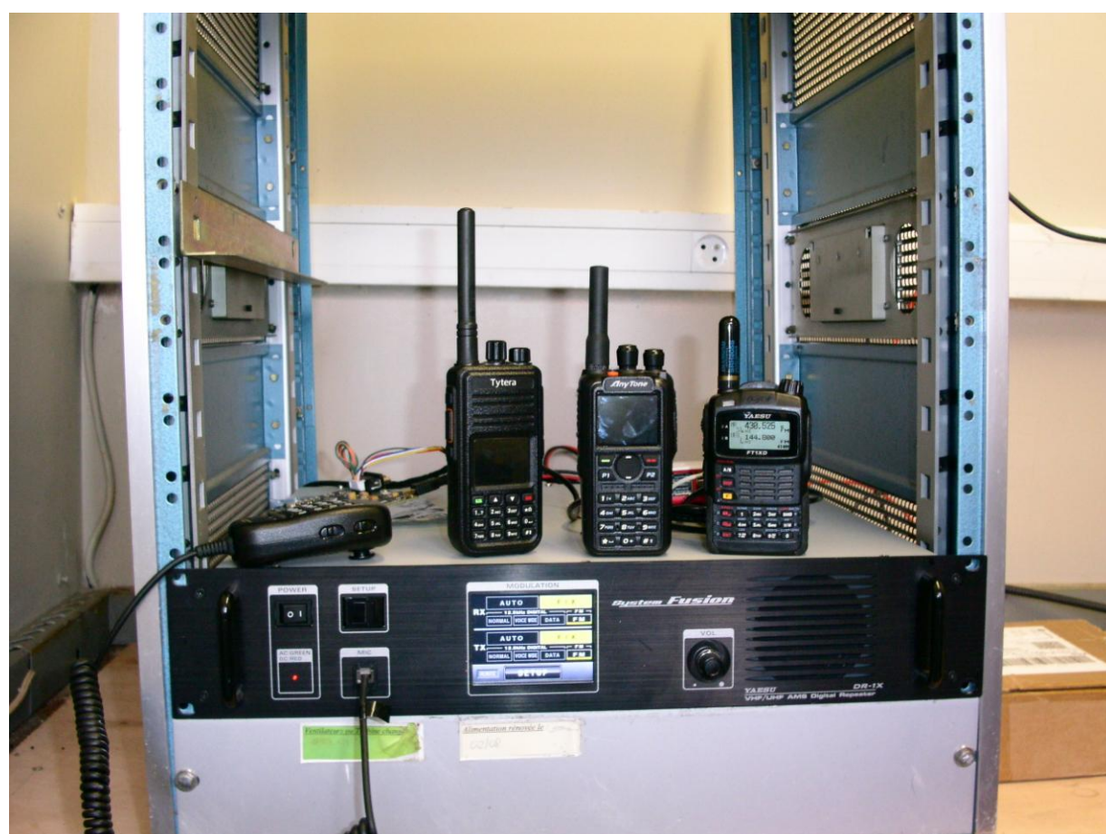
2020_01-18 DEPT 212 : Le rack en cours d'installation.
